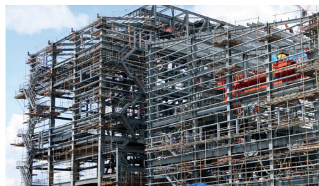
San Carlos Biopower 19,99-MW elektrárna na biomasu (Negros Occidental, Filipíny)
