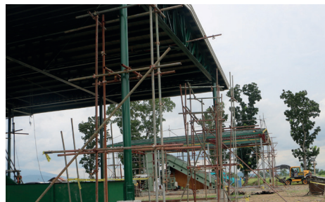
South Negros Biopower 24,99-MW elektrárna na biomasu (Negros Occidental, Filipíny)
