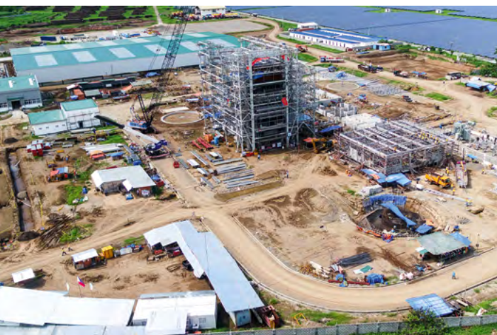
Elektrárna na biomasu South Negros BioPower/Filipíny
