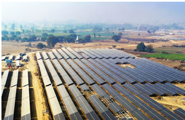
Das 75-MW-Solkraftwerk Uttar Pradesh I ist das bislang Grösste, das ThomasLloyd in Indien gebaut hat.
